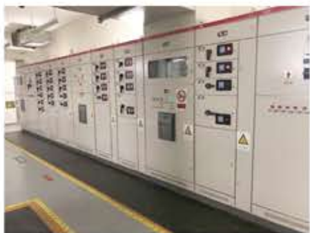
小区配电室向居民开放
